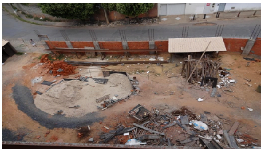
Figura 01 – Canteiro de obra sem Gestão de RCC.
