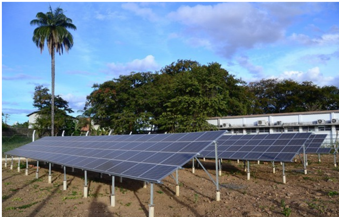
Figura 1. Usina Fotovoltaica da Universidade Estadual de Montes Claros.
